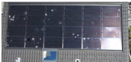
Abbildung 3: Drohnenaufnahme eines Hausdachs mit Hagelschäden, Bildrecht: Energie Netzwerk, Heinz Simmler.
