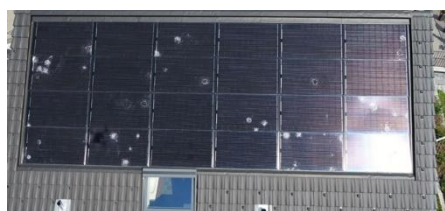
Figure 3 : Vue par drone du toit d'une maison endommagée par la grêle, droit d'image : Réseau énergie, Heinz Simmler.
